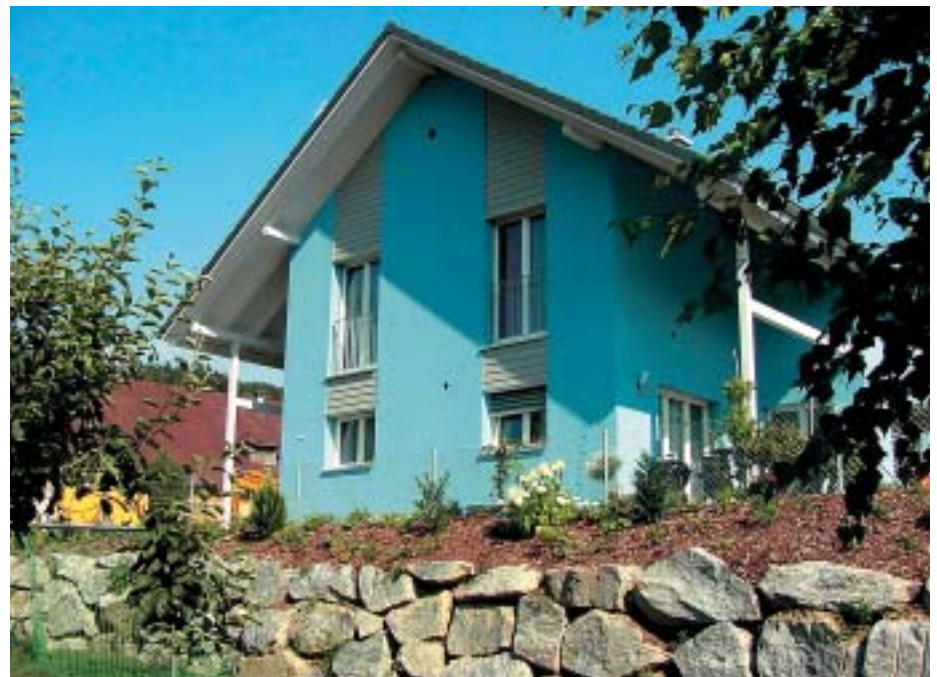
Blaugüne Fassade mit Phthalocyanblau und Grün. Der Hausbesitzer wird in zehn Jahren kaum mehr Freude an seiner Fassade haben, da die verwendeten Farben stark zu Kreidung neigen.
